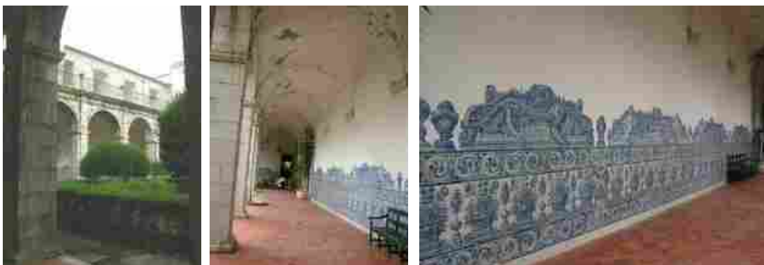
Piso inferior do claustro podendo ver-se os arcos, as abóbadas e os silhares de azulejo
