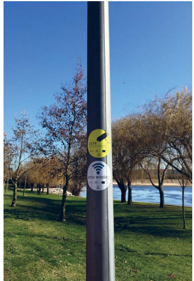
PONTO WI-FI INTEGRADO EM POSTE DE ILUMINAÇÃO PÚBLICA
