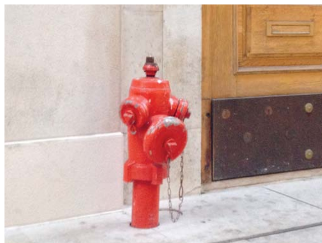
HIDRANTE JUNTO À FACHADA DO EDIFÍCIO
