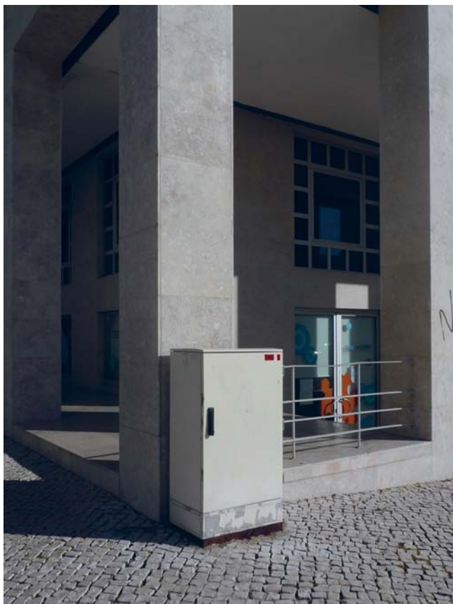
BOA PRÁTICA – ARMÁRIO ADOSSADO AO EDIFÍCIO
