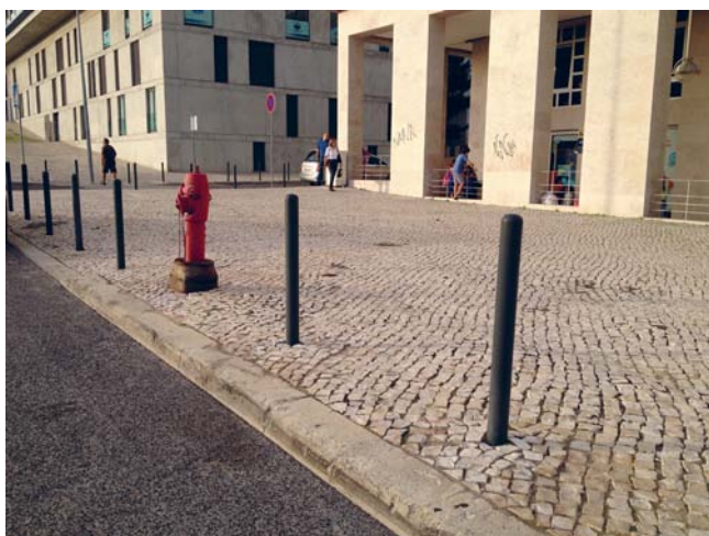
HIDRANTE JUNTO AO LIMITE EXTERIOR DO PASSEIO
