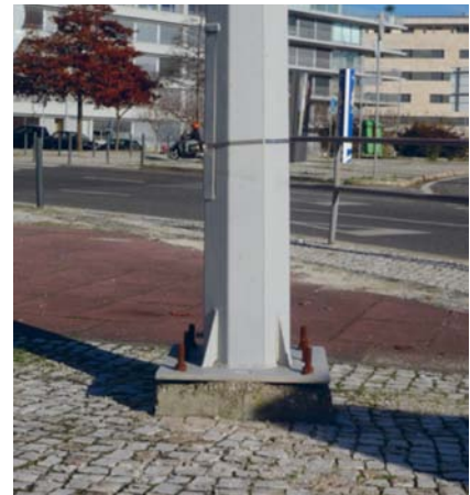
MÁ PRÁTICA – A EVITAR. O MACIÇO E OS PERNES DE FIXAÇÃO NÃO DEVEM RESSALTAR DA COTA DO PAVIMENTO
