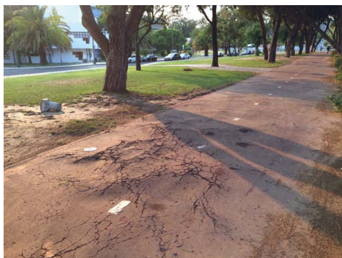
FISSURAÇÃO E DEFORMAÇÃO DE PERCURSO CICLÁVEL
