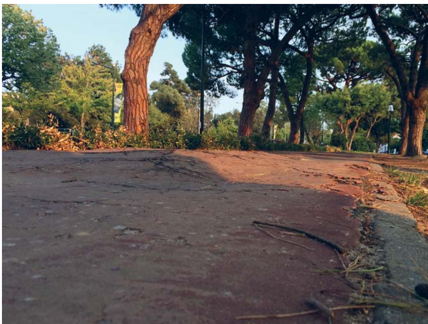
LISBOA - MAU ESTADO DE CONSERVAÇÃO DO PAVIMENTO
