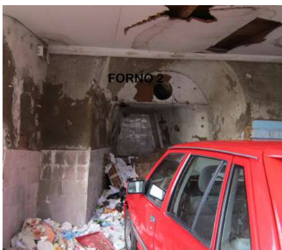
Fig. 7 – A entrada da boca do forno, adaptada a chaminé de cozinha, quase oculta pelo edificado recente (agora garagem).
